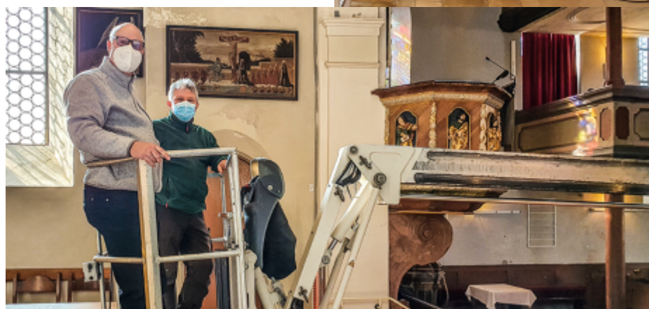
Pfarrer Gotthard Münsterlein und Mesner Vladimir Gembel bei der Besichtigung der Schäden.
